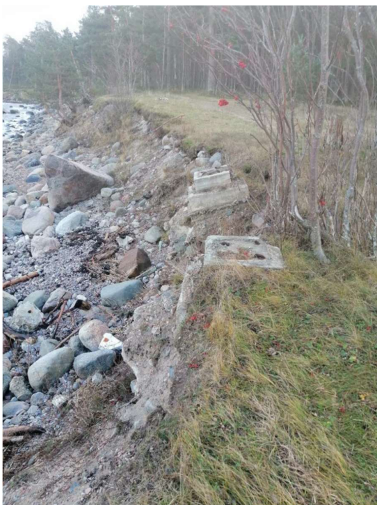
Foto 3. Nõlvakahjustus Kordoni tee 65 kinnisasja idaküljel. Allikas: Eksperthinnang kaldakindlustuse vajalikkusest Kordoni 65 kinnistule.
