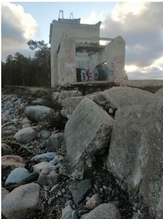
Foto 1. Kordonihoone. Vaade põhjast. Esiplaanil lagunenud prožektoriväljak. Allikas: Eksperthinnang kaldakindlustuse vajalikkusest Kordoni 65 kinnistule.
